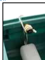
avec un câble chauffant autour du flotteur
